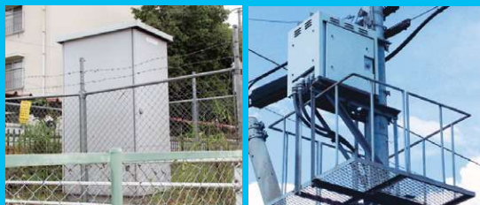
路上局A(電動弁制御所)
