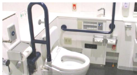
施工段階での意見を元に 肘が当たらないよう手摺位置を調整 (熊本城ホール)
