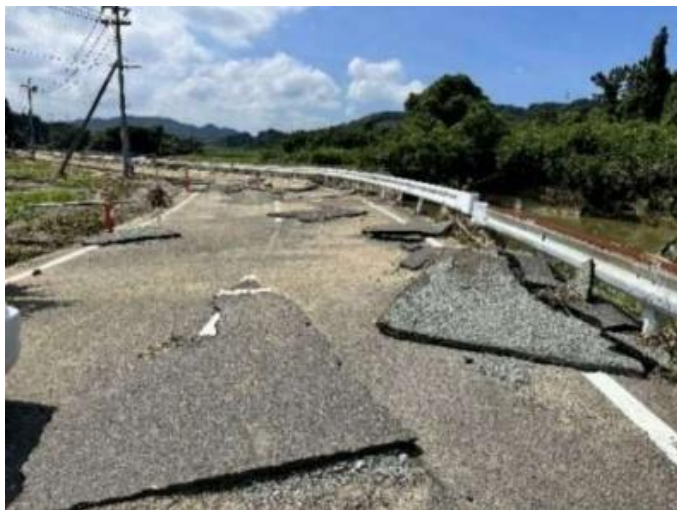
浜戸川越水による舗装損壊（南区城南町鰐瀬地内）
