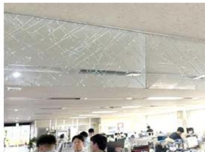
防煙垂れ壁（ガラス）破損
