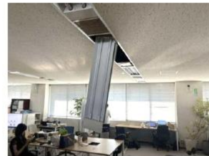
照明器具落下
