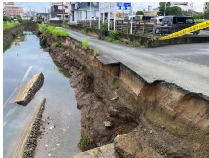
健軍川護岸崩壊（東区神水本町）
