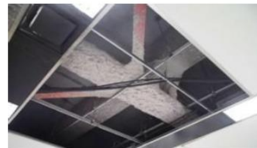
天井パネル落下
