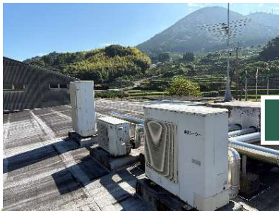
既設室外機設置状況
