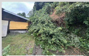
西区上松尾町 施設(道路) 土砂流入N=1箇所
