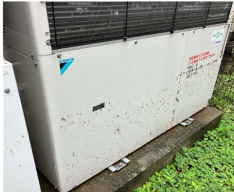
西山中学校 GHP室外機浸水状況
