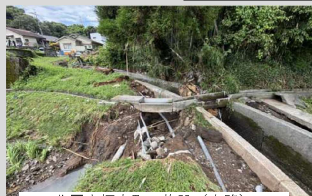
北区立福寺町 施設(水路) 断面閉塞(流木) N=1箇所
