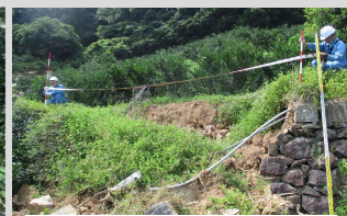
西区河内町河内 農地(樹園地) 法面崩壊L=6.7m
