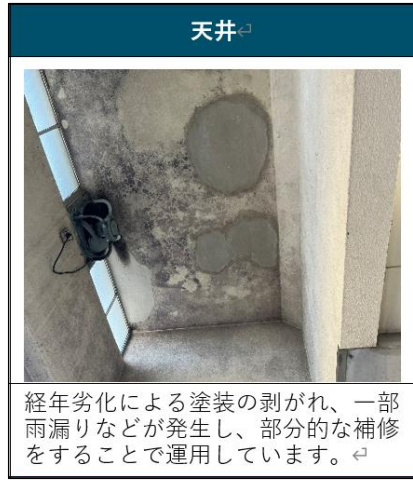
給食施設の劣化状況例
