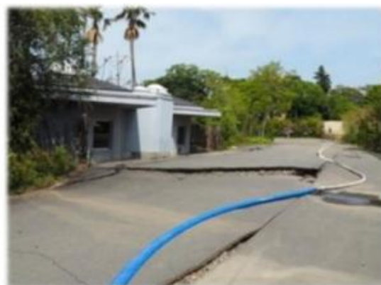
園路の被災状況
