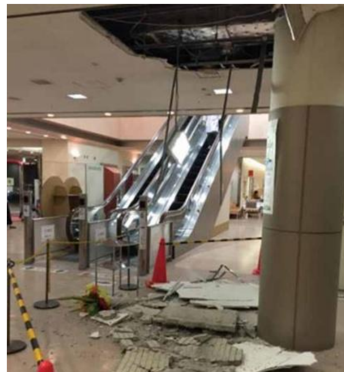
▲ 市民病院新館待合ホール天井材落下の状況
