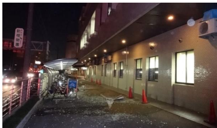
▲ 南館2階検査部門窓破損落下
