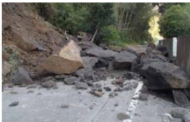
▲ 一般県道玉名植木線 法面の崩壊
