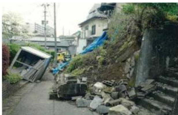
▲ 宅地擁壁の被災状況
