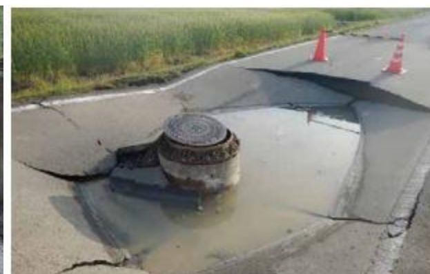
▲ 下水道(管路)の被災状況
