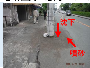
液状化の被害
