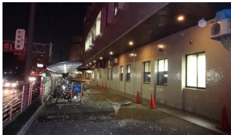
▲ 南館2階検査部門窓破損落下
