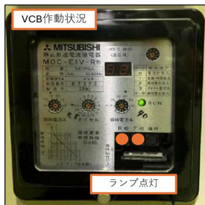
写真 4-7 VCB（安全装置）作動状況
