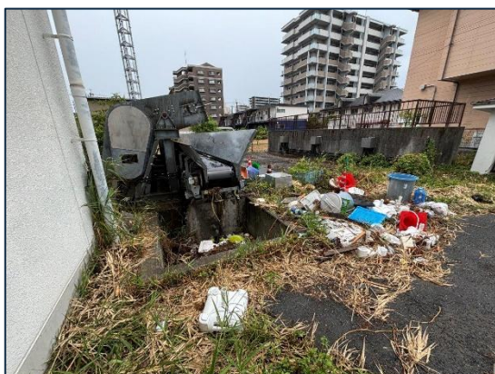
写真 4-6 除塵機周辺の漂流物の状況
