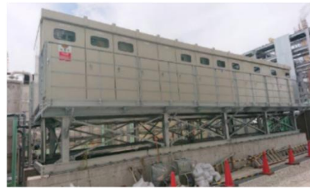
受電盤かさ上げイメージ
