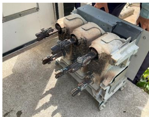
写真 5-2 焼損した機器 (VCB)
