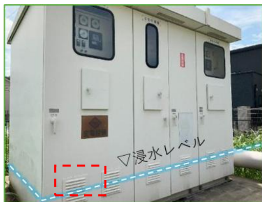
写真 5-1 高圧受電盤 浸水状況
