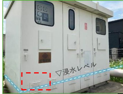
③ 高圧受電盤 浸水状況 (屋外)
