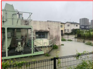
中継ポンプ場浸水状況 (機器損傷により機能停止)
