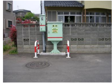
マンホールポンプ場
