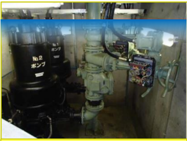
ポンプ室浸水 (青ラインまで浸水)
