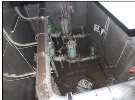
⑦ 地下ポンプ室被害状況
