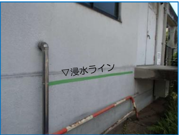
中継ポンプ場浸水深 (入口ドア下まで水位がある)
