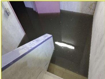
中継ポンプ場浸水 (地下が水没)
