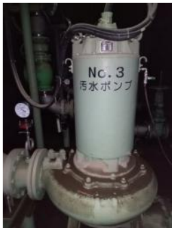
⑧ 機器類 (汚水ポンプ)
