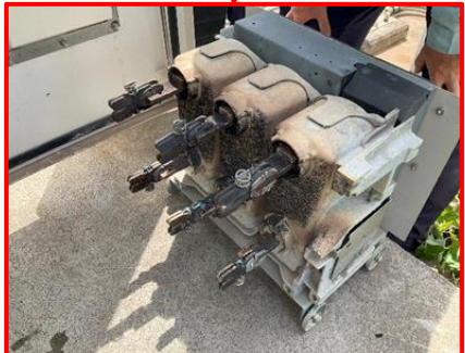
④ 焼損した機器 (VCB)
