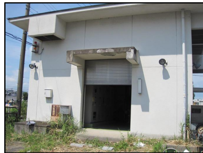
盤関係 (建屋内)
