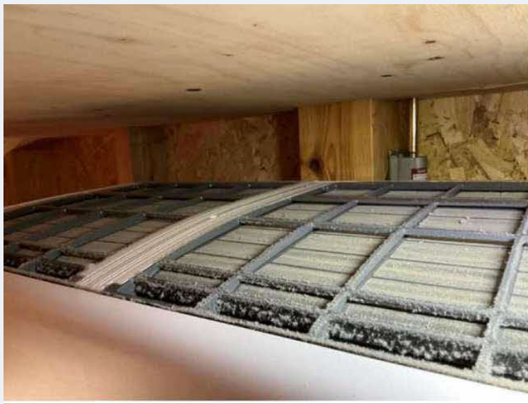
木くず等埃が原因で目詰まり
