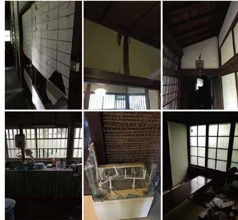
倒壊は免れたものの、障子は破れ、壁に亀裂が入り、地震の揺れの激しさを物語っている。
