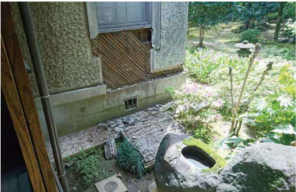
洋館の外壁も一部崩落した。庭も石碑や石塔が倒れた。熊本地震は前震も本震も夜の発生だったため、人的被害は出さずに済んだ。
