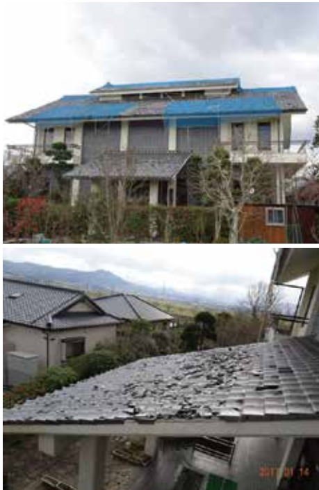
四時軒に隣接する横井小楠記念館は瓦が落ちる程度の被害にとどまったが、しばらくは雨漏りが続き、3カ月ほど休館した。展示物に被害はなかった。
