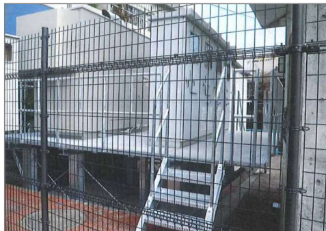
浸水対策【排水機場耐水化(設備高上げ)】
