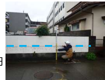
井芹川第8・10排水区浸水痕
