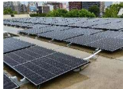
市立学校に導入した太陽光発電設備
