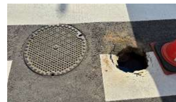
陥没した道路の様子
