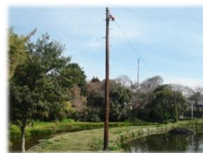
老朽化した照明灯
