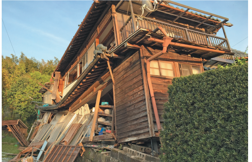
4月16日の本震で大きく傾いた民家
