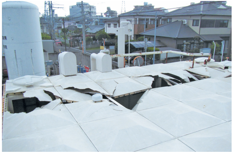
水が大きく揺れ動いたことで天井が割れた貯水槽
