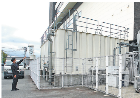
より耐震性を高めた貯水槽
