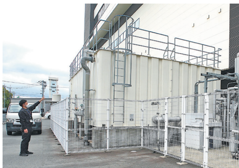
より耐震性を高めた貯水槽
