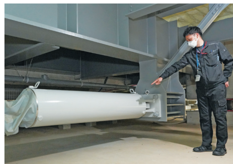
地下に設置された、地震時に建物の揺れを抑えるオイルダンパー
