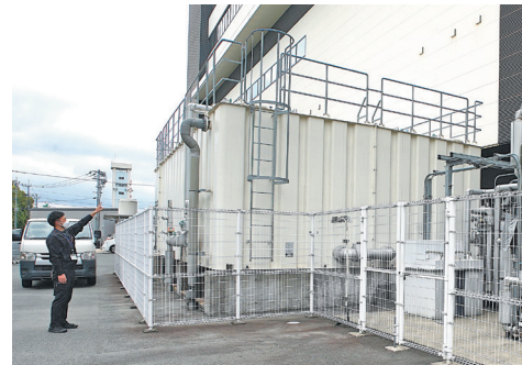
より耐震性を高めた貯水槽
