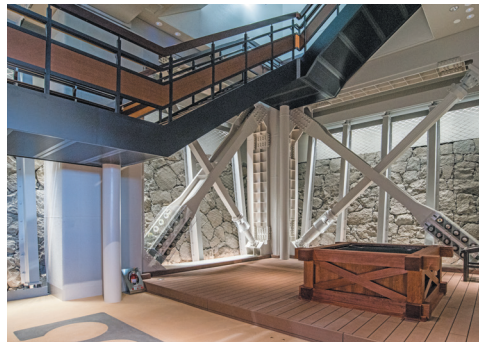
天守閣に設置された制振ダンパー。見学できるよう露出させている
