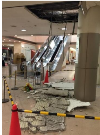
▲ 新館待合ホール天井材落下
