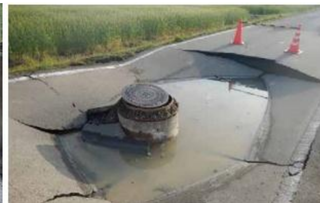
▲ 下水道(管路)の被災状況
