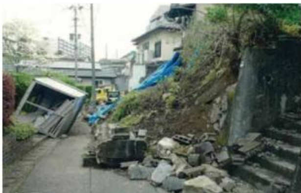
▲ 宅地擁壁の被災状況
