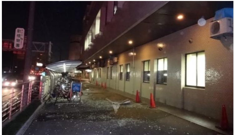
▲ 南館2階検査部門窓破損落下
