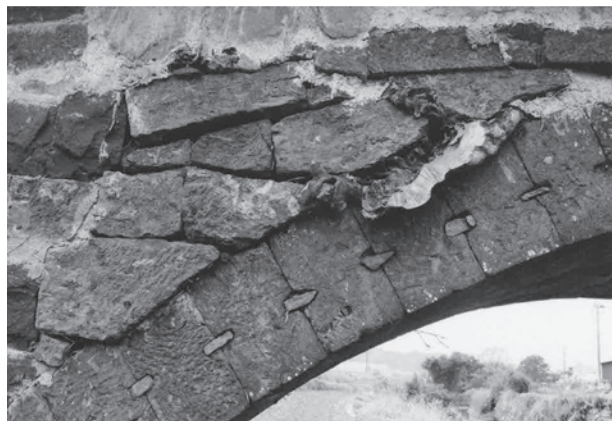
上流側左岸上部の旧材
