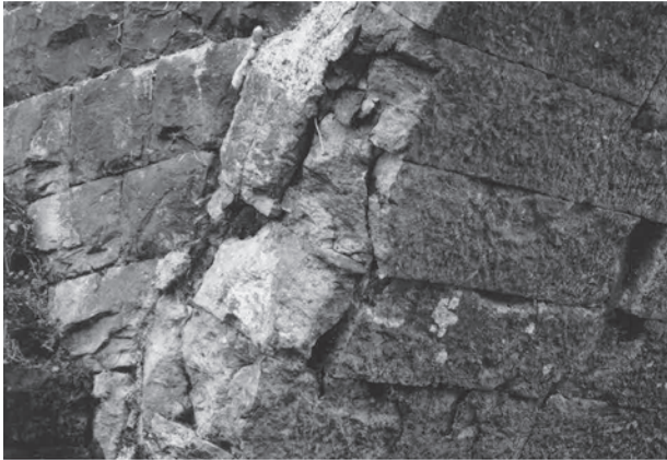
上流側左岸輪石下部の破損
