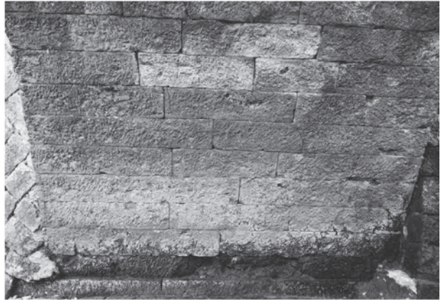
右岸輪石、破損などは少ない
