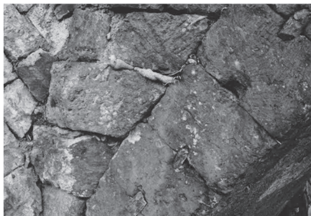
下流側右岸壁石下部の削痕
