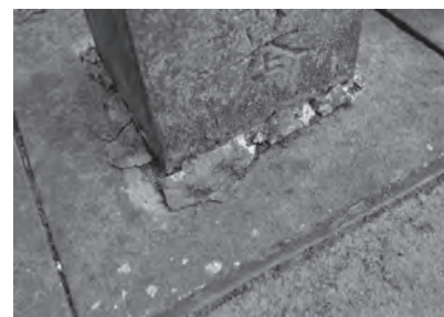
No.3列-36, 目地割れ
