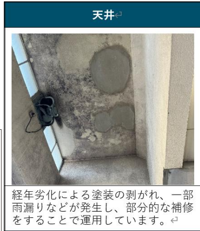
給食施設の劣化状況例
