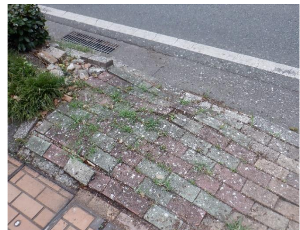
ムクドリによる糞害の状況
