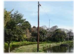
老朽化した照明灯
