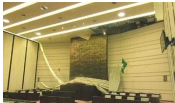
議会棟天井落下
