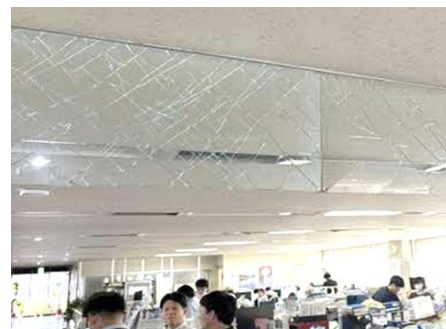
防煙垂れ壁（ガラス）破損
