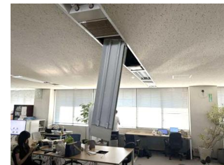
照明器具落下
