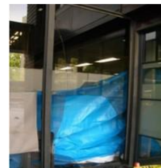
1階ガラス破損
