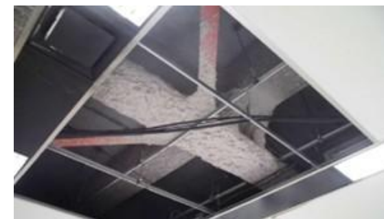
天井パネル落下
