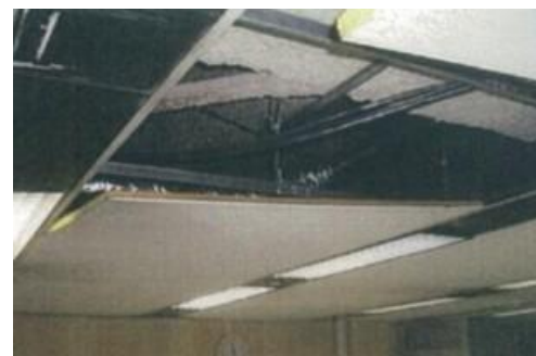
天井パネル落下
