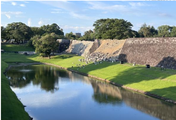
西出丸西側石垣 崩落
