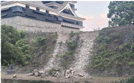
平左衛門丸石垣 崩落
