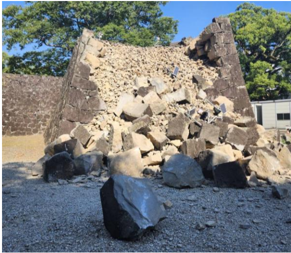
竹の丸石垣 崩落
