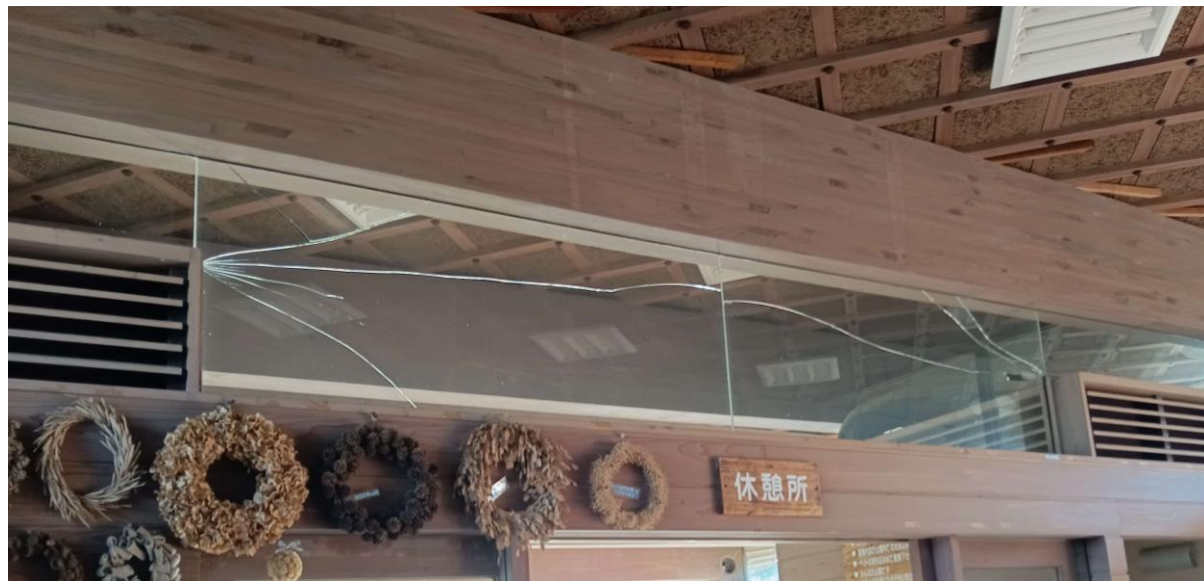
管理棟ガラス割れ
