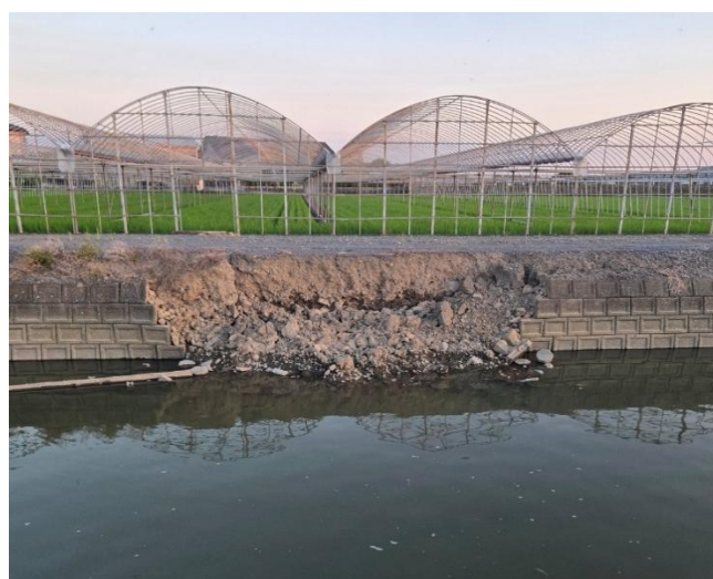
水路の護岸の破損（南区富合町）
