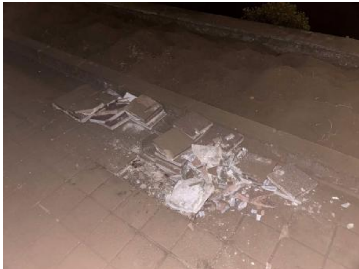
遊歩道タイルの割れ 2
