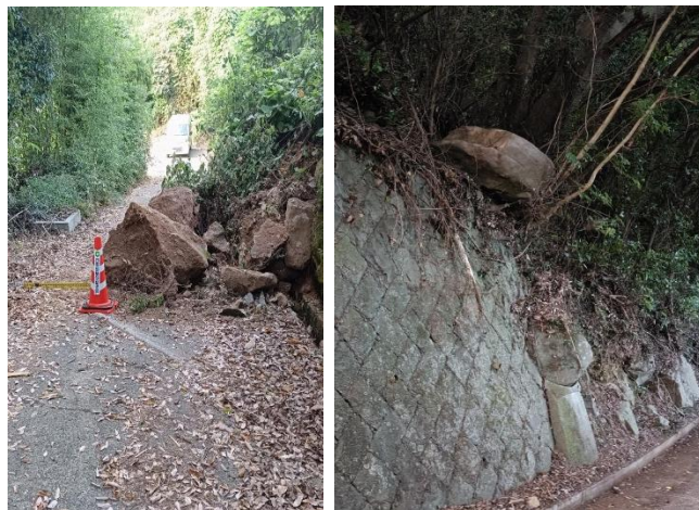
農道への落石（西区河内町）
