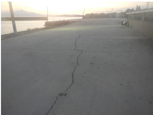
漁港の舗装のヒビ割れ（南区川口町）
