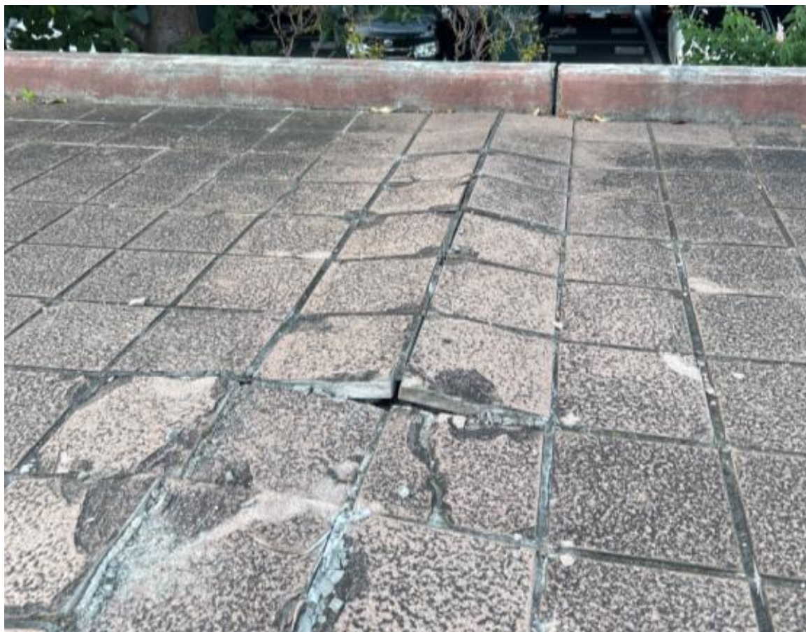
遊歩道タイルの割れ 1
