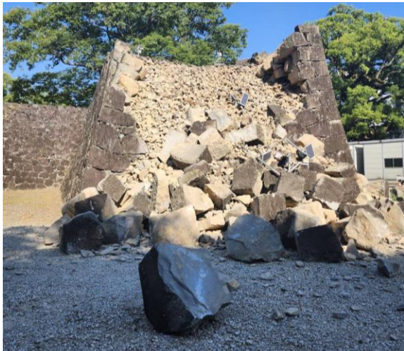
竹の丸石垣 崩落
