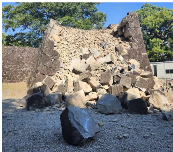
竹の丸石垣 崩落
