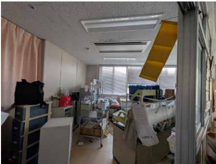
高齢者施設(施設内への被害)
