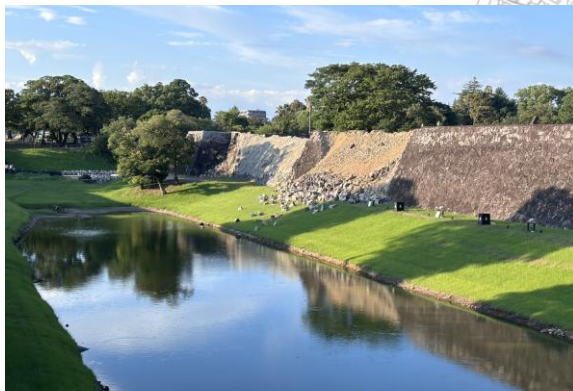
西出丸西側石垣 崩落
