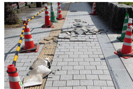
タイル舗装の割れ等
