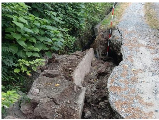
水路の崩落（南区城南町）
