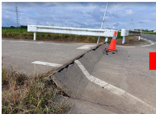
農道舗装板の破損（東区秋津）
