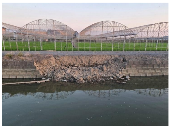
水路護岸の破損（南区富合町）
