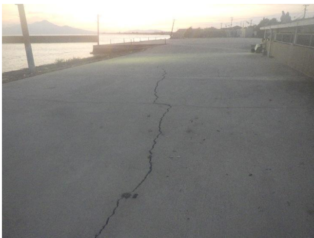
漁港の舗装のヒビ割れ（南区川口町）
