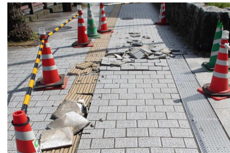
タイル舗装の割れ等
