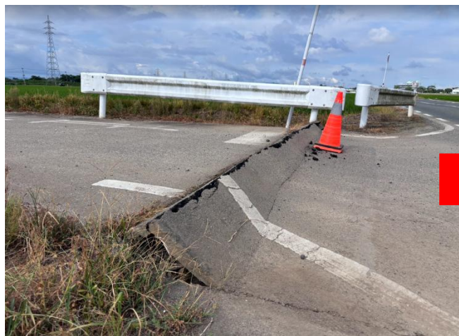
農道舗装板の破損（東区秋津）
