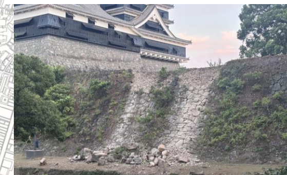
平左衛門丸石垣 崩落
