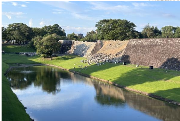
西出丸西側石垣 崩落
