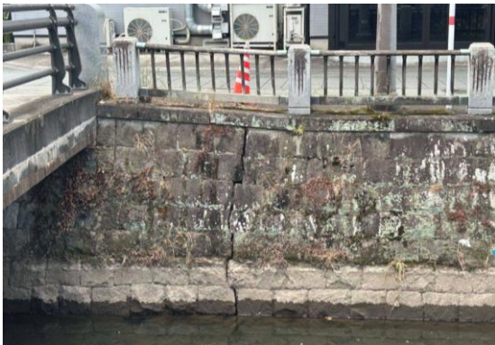
大井手川護岸ひび割れ
