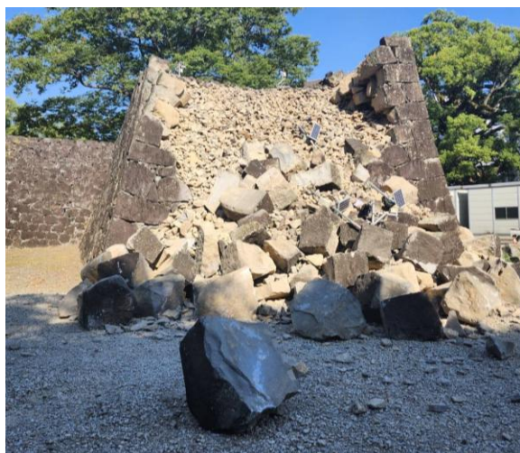
竹の丸石垣 崩落
