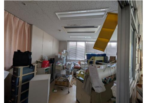
高齢者施設(施設内への被害)
