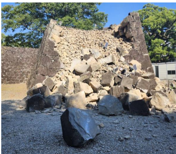
竹の丸石垣 崩落
