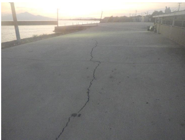
漁港の舗装のヒビ割れ（南区川口町）
