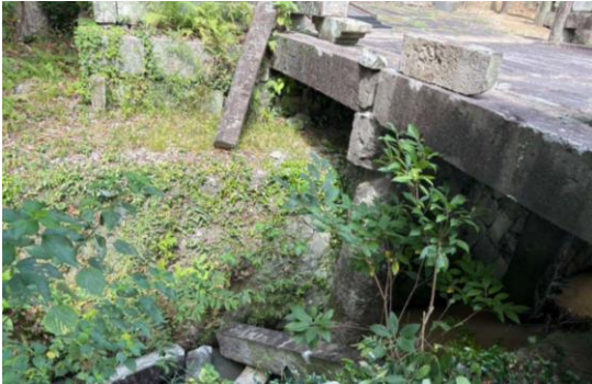
井芹都市下水路
