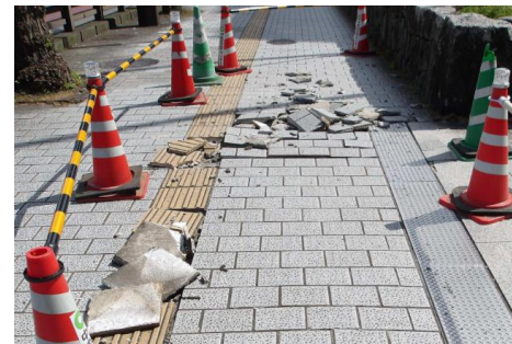
タイル舗装の割れ等
