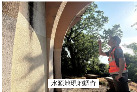
水源地被災状況
