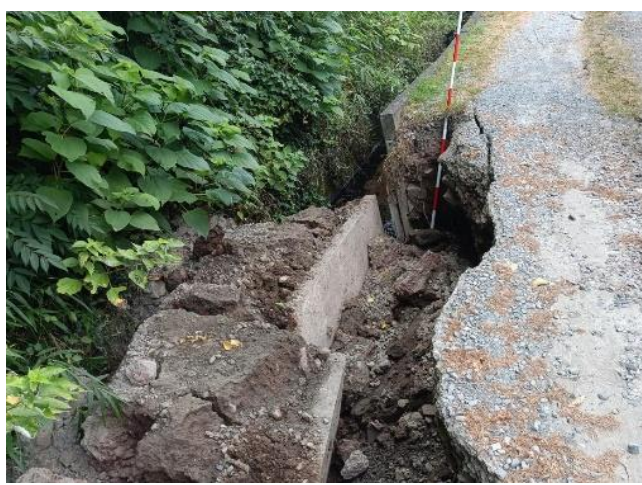
水路の崩落（南区城南町）
