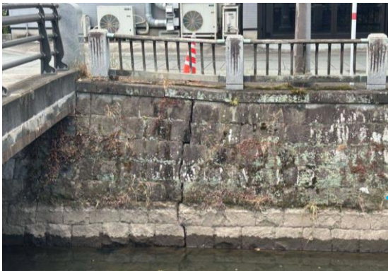
大井手川護岸ひび割れ
