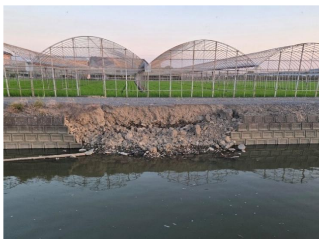
水路護岸の破損（南区富合町）
