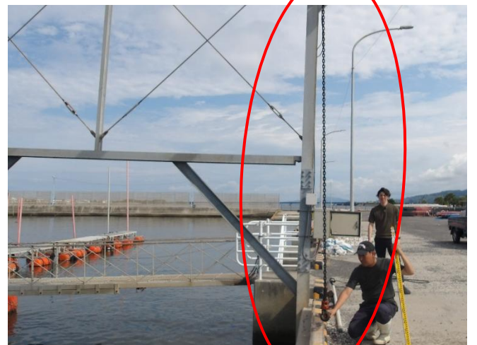
ホイストクレーンが陸地側に傾斜（南区海路口町）
