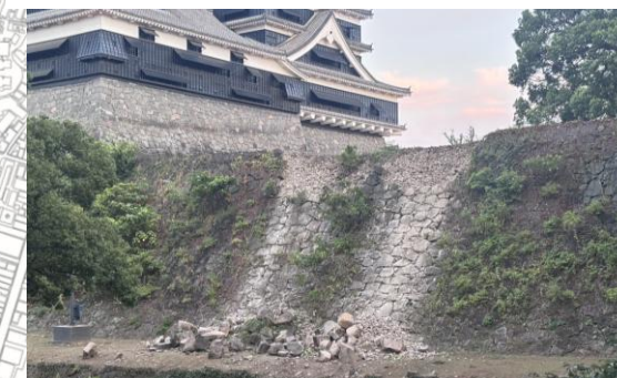
平左衛門丸石垣 崩落
