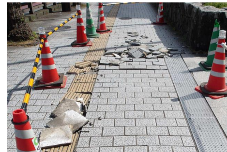
タイル舗装の割れ等
