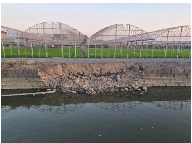
水路護岸の破損（南区富合町）
