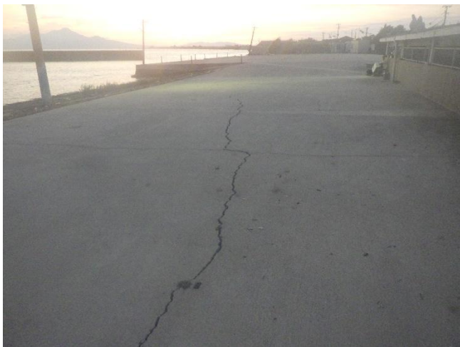
漁港の舗装のヒビ割れ（南区川口町）
