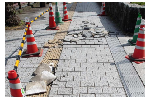
タイル舗装の割れ等
