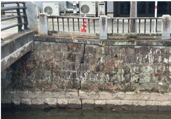
大井手川護岸ひび割れ
