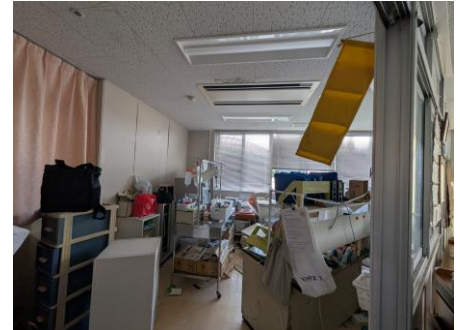
高齢者施設(施設内への被害)
