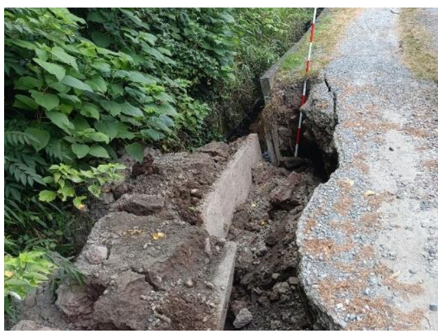
水路の崩落（南区城南町）
