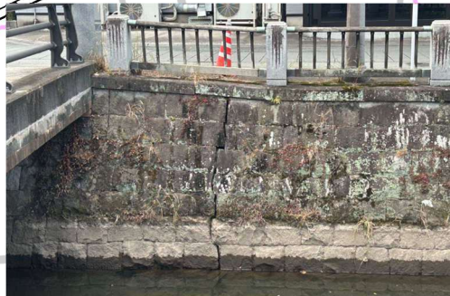
大井手川護岸ひび割れ
