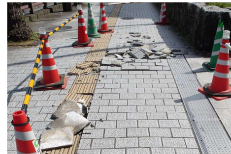
タイル舗装の割れ等
