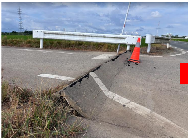
農道舗装板の破損（東区秋津）
