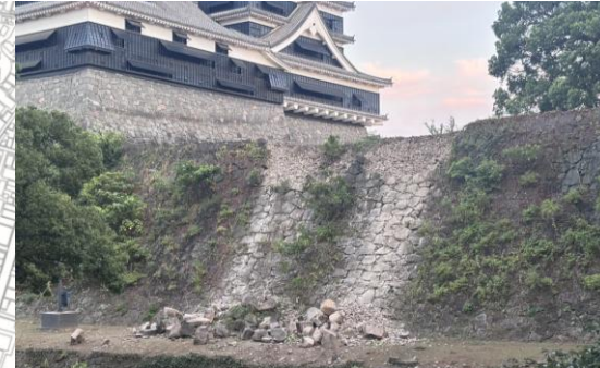
平左衛門丸石垣 崩落
