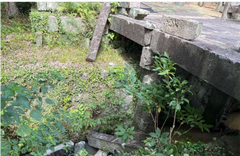
井芹都市下水路
