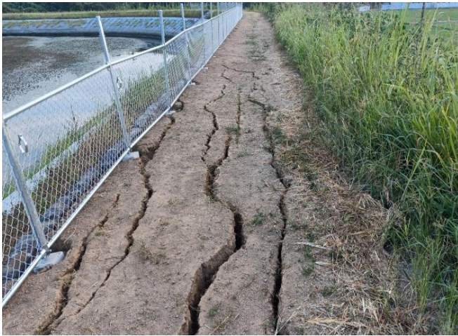
ため池の堤体のヒビ割れ（南区城南町/新地ため池）
