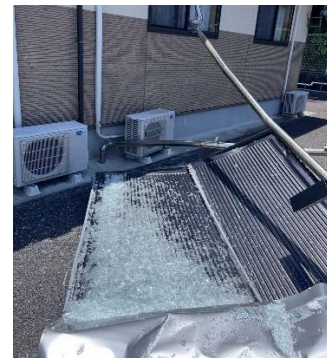
障害福祉施設(施設への被害)
