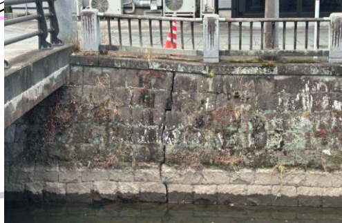
大井手川護岸ひび割れ
