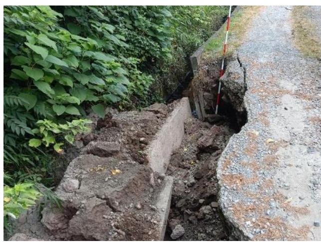
水路の崩落（南区城南町）
