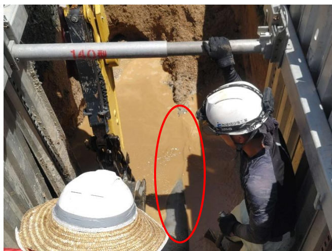
用水管の漏水（東区秋津）
