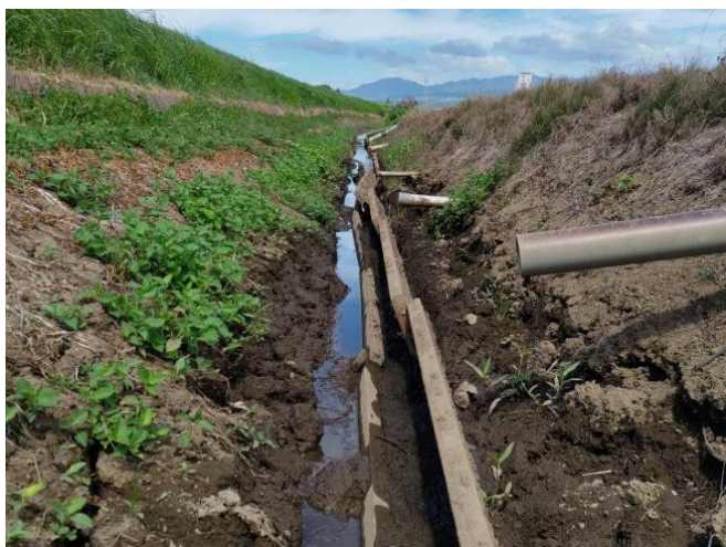
排水路の破損（東区秋津）
