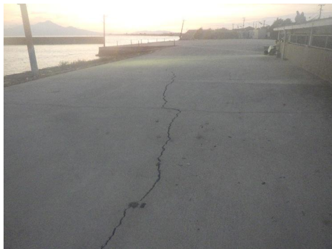
漁港の舗装のヒビ割れ（南区川口町）
