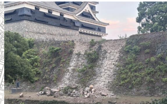
平左衛門丸石垣 崩落
