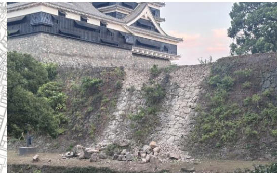
平左衛門丸石垣 崩落
