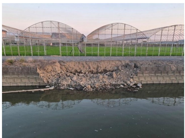
水路護岸の破損（南区富合町）
