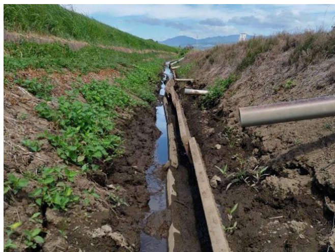
排水路の破損（東区秋津）
