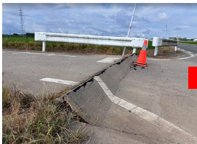
農道舗装板の破損（東区秋津）
