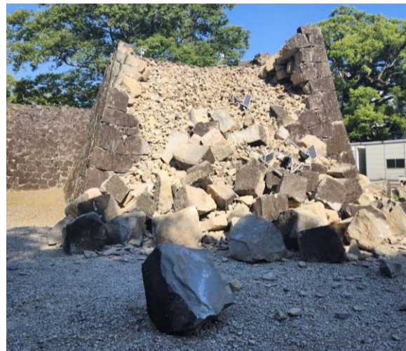
竹の丸石垣 崩落
