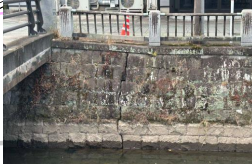
大井手川護岸ひび割れ
