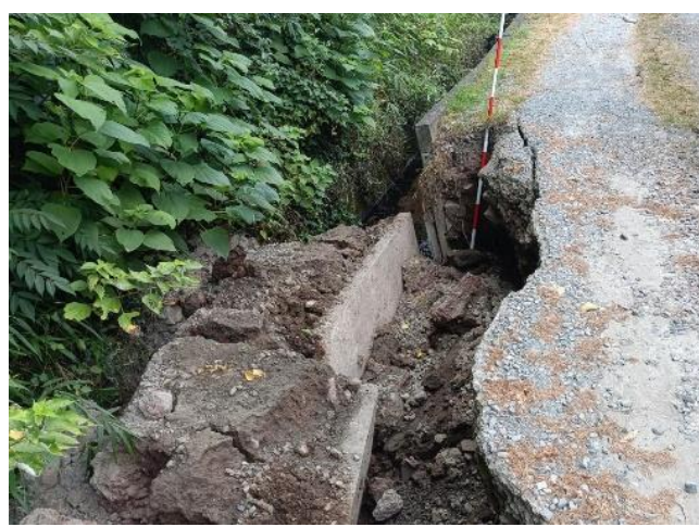
水路の崩落（南区城南町）
