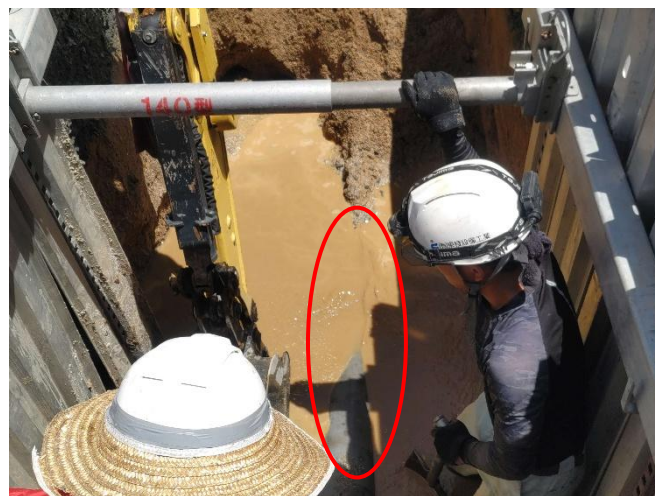
用水管の漏水（東区秋津）
