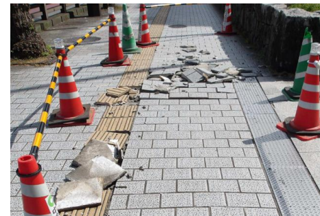
タイル舗装の割れ等
