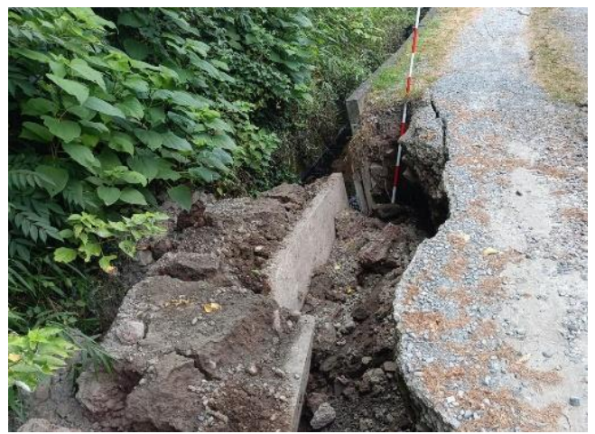
水路の崩落（南区城南町）
