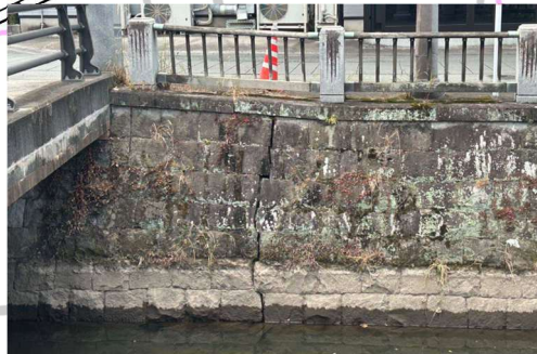
大井手川護岸ひび割れ
