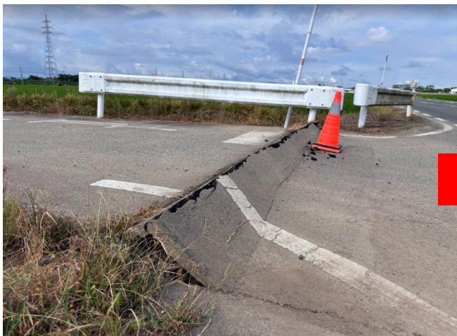
農道舗装板の破損（東区秋津）
