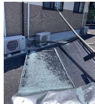
障害福祉施設(施設への被害)
