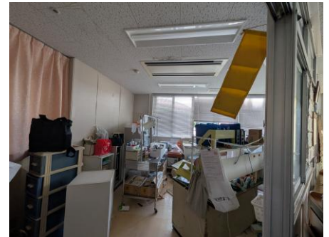
高齢者施設(施設内への被害)
