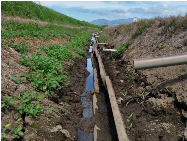
排水路の破損（東区秋津）
