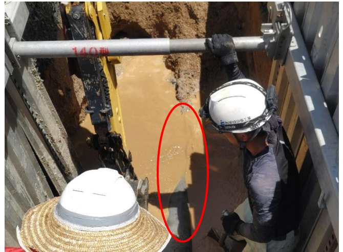
用水管の漏水（東区秋津）
