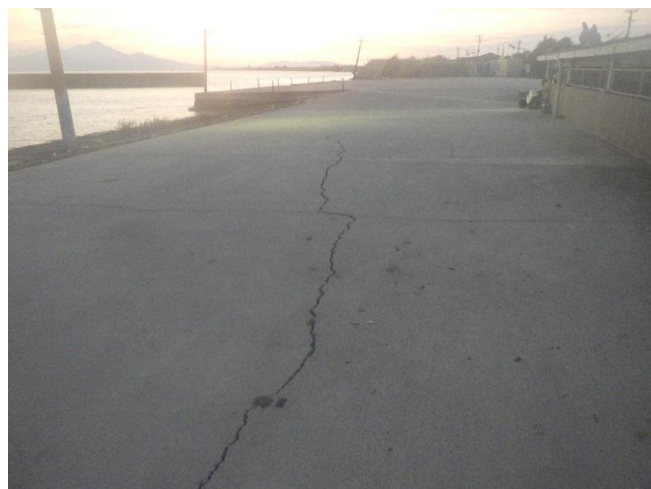
漁港の舗装のヒビ割れ（南区川口町）
