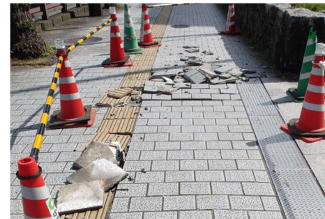
タイル舗装の割れ等
