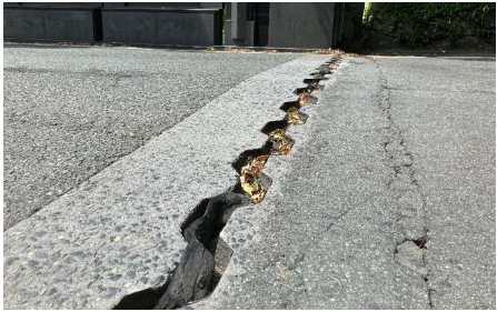
桜橋 (伸縮装置の遊間異状)
