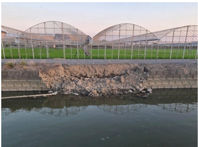
水路護岸の破損（南区富合町）
