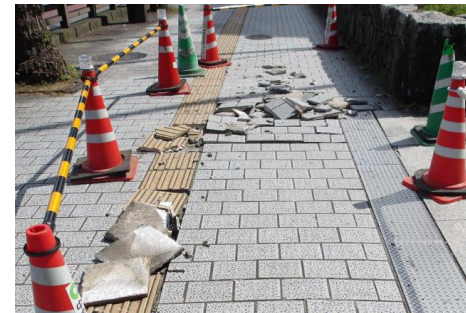
タイル舗装の割れ等
