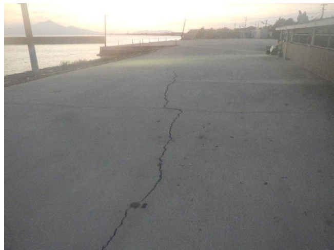
漁港の舗装のヒビ割れ（南区川口町）
