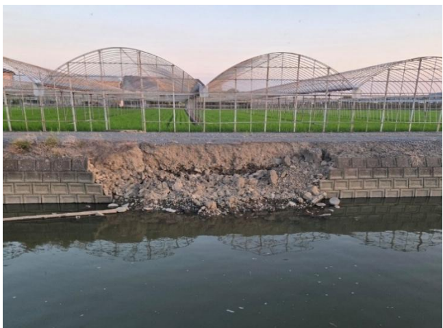
水路護岸の破損（南区富合町）
