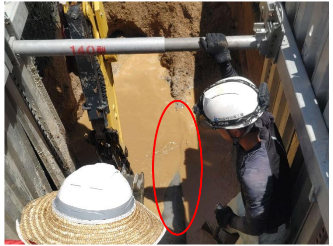
用水管の漏水（東区秋津）
