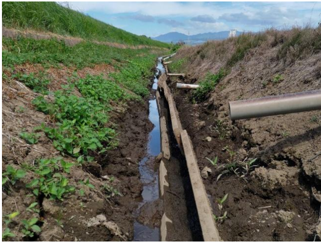
排水路の破損（東区秋津）
