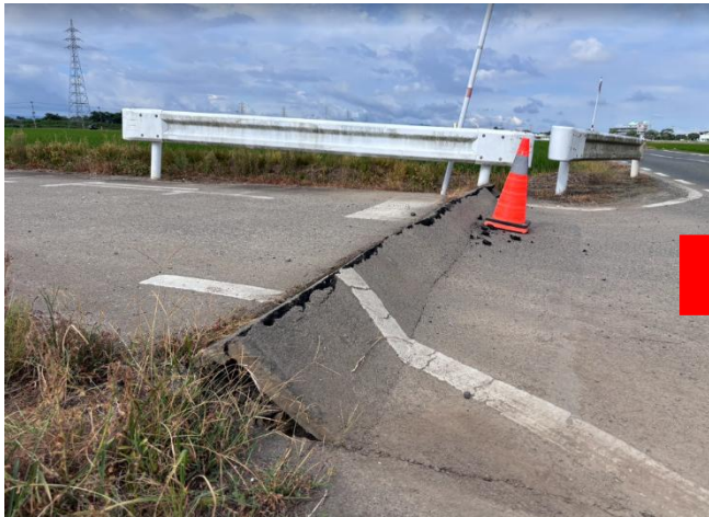
農道舗装板の破損（東区秋津）
