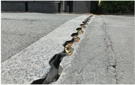
桜橋(伸縮装置の遊間異状)
