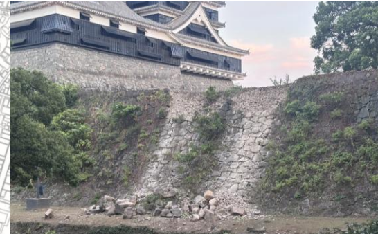
平左衛門丸石垣 崩落
