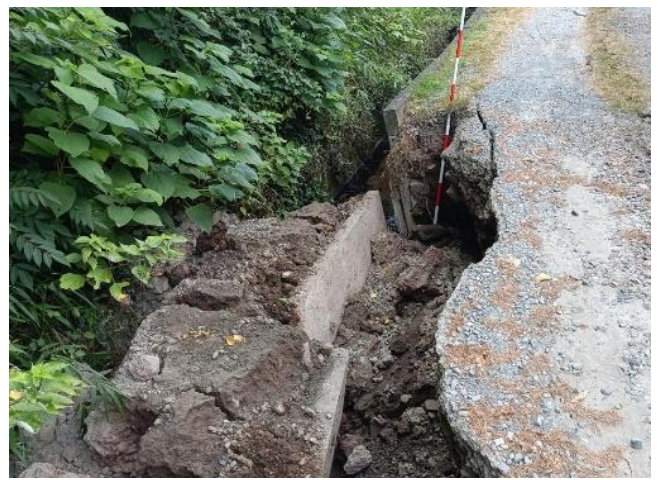
水路の崩落（南区城南町）
