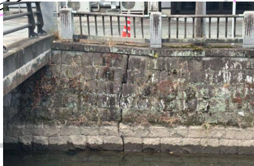
大井手川護岸ひび割れ
