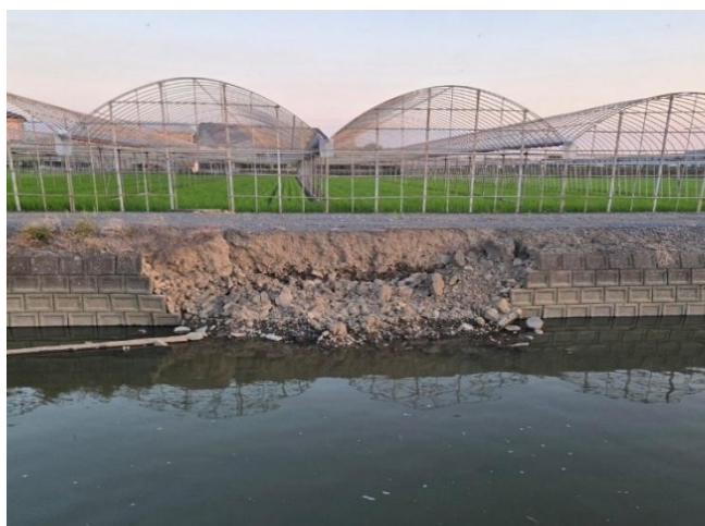
水路護岸の破損（南区富合町）
