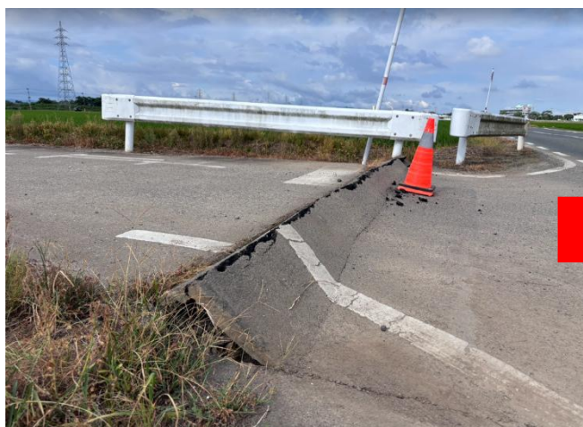
農道舗装板の破損（東区秋津）
