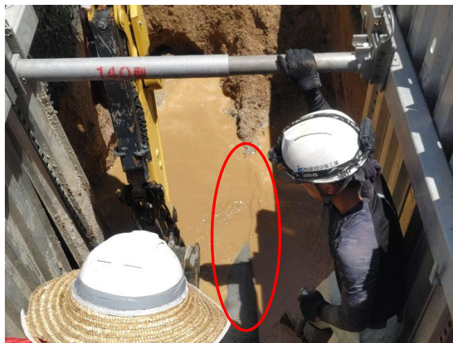
用水管の漏水（東区秋津）
