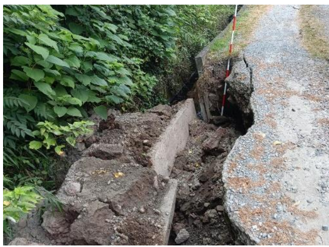
水路の崩落（南区城南町）
