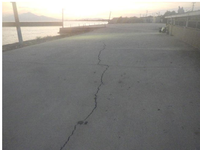
漁港の舗装のヒビ割れ（南区川口町）
