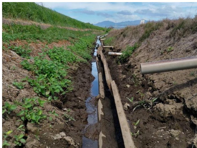
排水路の破損（東区秋津）
