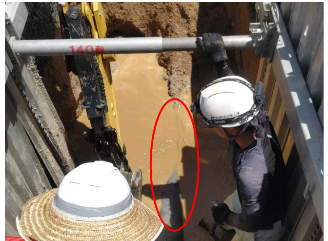
用水管の漏水（東区秋津）
