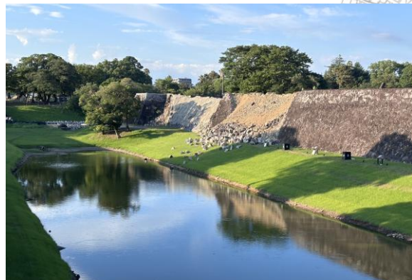
西出丸西側石垣 崩落
