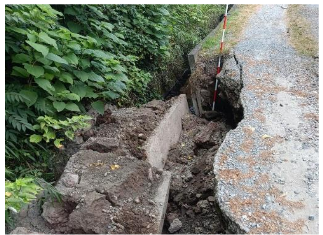
水路の崩落（南区城南町）
