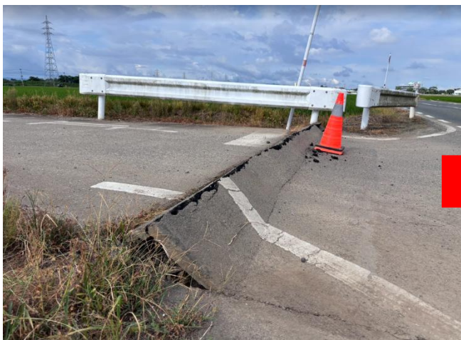
農道舗装板の破損（東区秋津）
