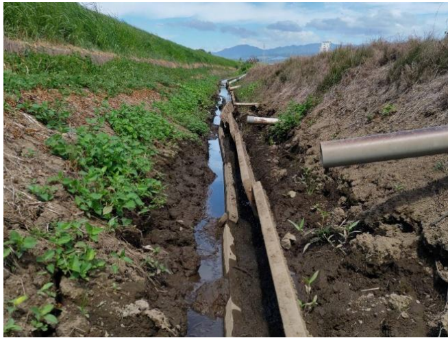
排水路の破損（東区秋津）
