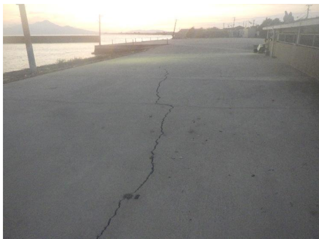
漁港の舗装のヒビ割れ（南区川口町）
