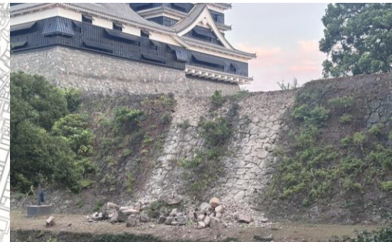
平左衛門丸石垣 崩落
