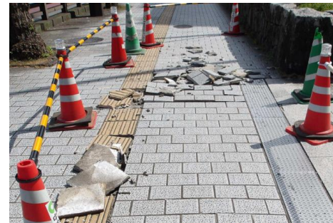
タイル舗装の割れ等
