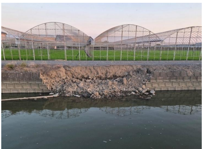
水路護岸の破損（南区富合町）
