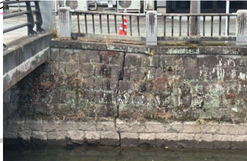
大井手川護岸ひび割れ
