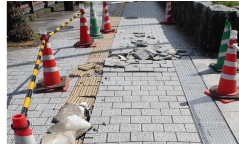
タイル舗装の割れ等
