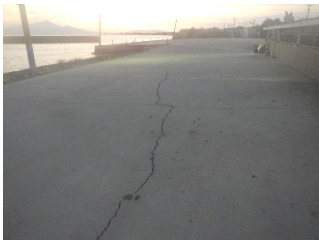
漁港の舗装のヒビ割れ（南区川口町）
