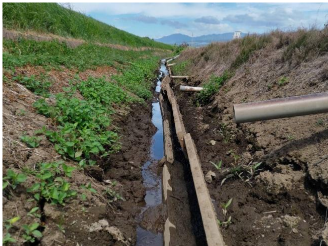
排水路の破損（東区秋津）
