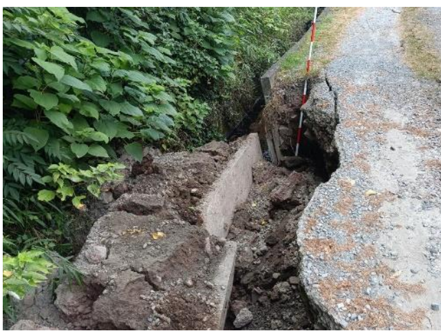
水路の崩落（南区城南町）
