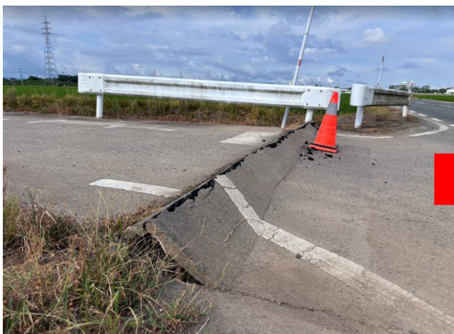
農道舗装板の破損（東区秋津）
