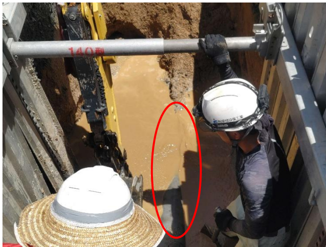
用水管の漏水（東区秋津）
