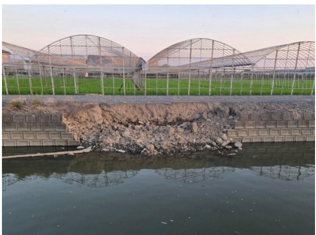
水路護岸の破損（南区富合町）
