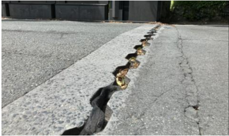
桜橋(伸縮装置の遊間異状)
