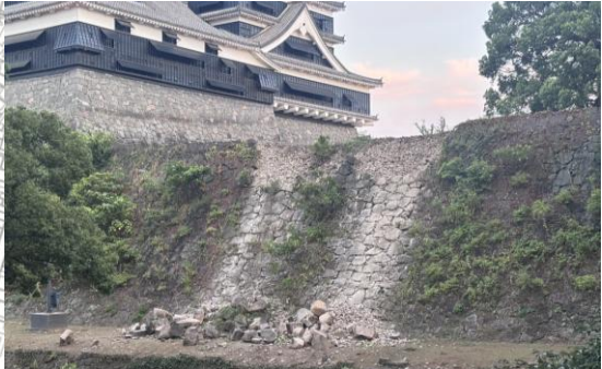
平左衛門丸石垣 崩落
