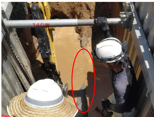
用水管の漏水（東区秋津）
