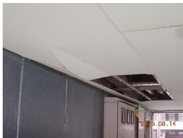
ポーチ天井被害
