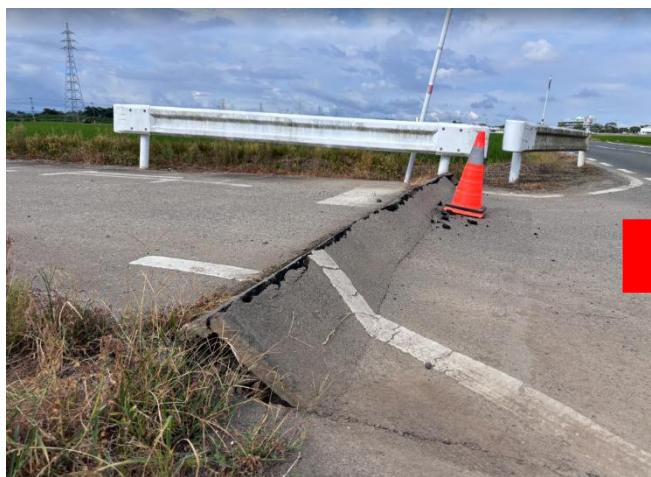
農道舗装板の破損（東区秋津）
