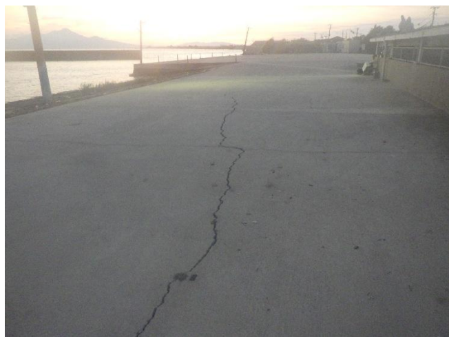
漁港の舗装のヒビ割れ（南区川口町）
