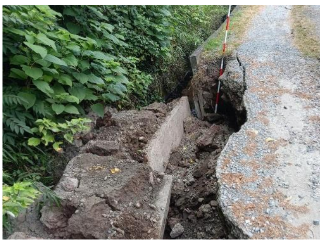
水路の崩落（南区城南町）
