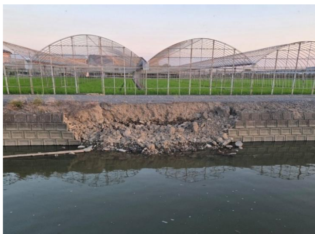
水路護岸の破損（南区富合町）
