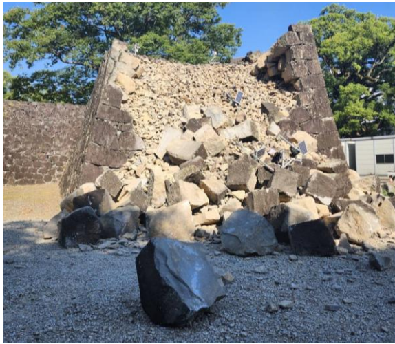
竹の丸石垣 崩落
