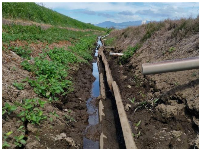
排水路の破損（東区秋津）
