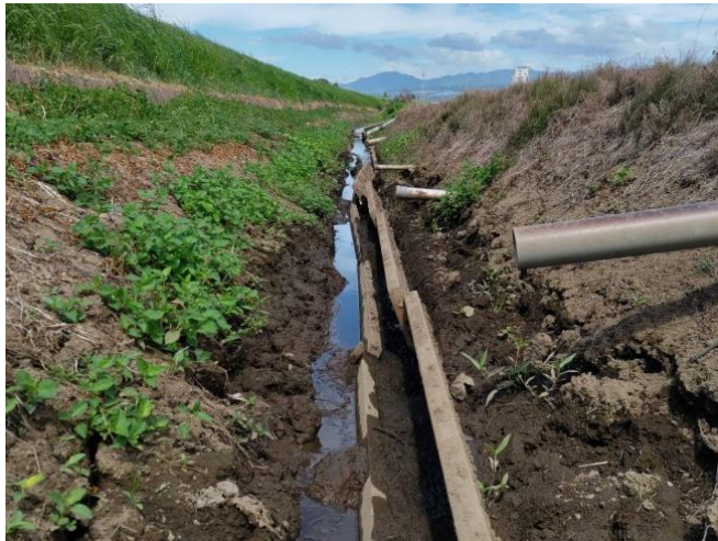
排水路の破損（東区秋津）
