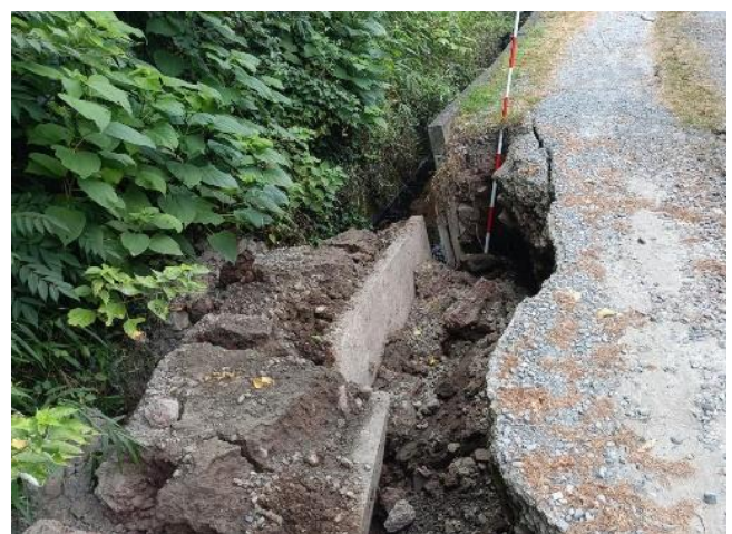
水路の崩落（南区城南町）
