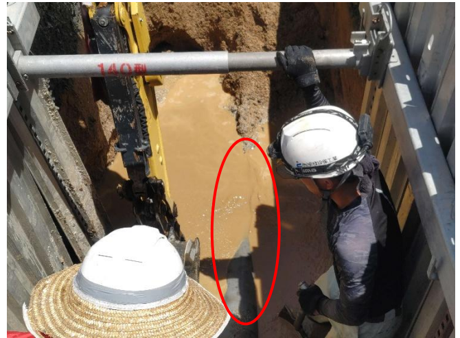
用水管の漏水（東区秋津）
