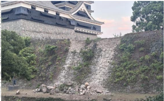
平左衛門丸石垣 崩落
