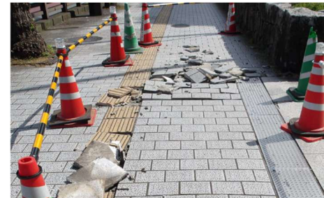
タイル舗装の割れ等
