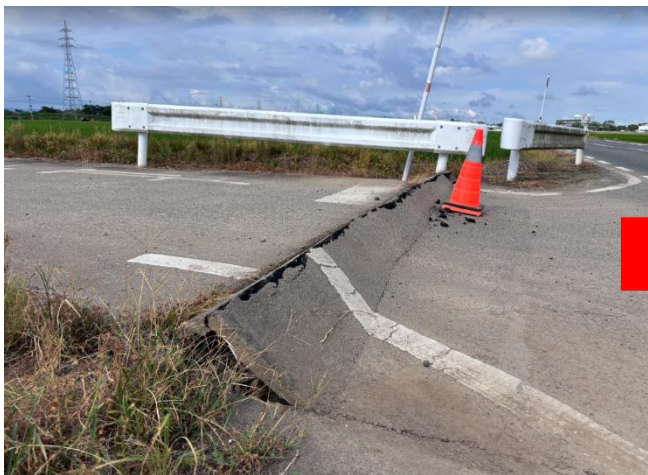
農道舗装板の破損（東区秋津）
