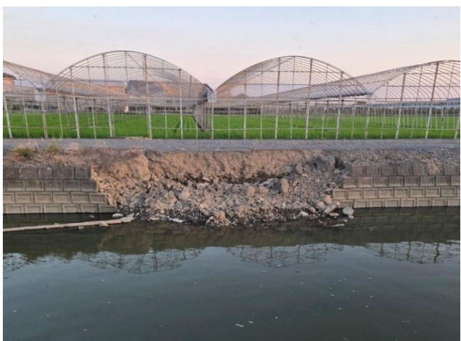
水路護岸の破損（南区富合町）
