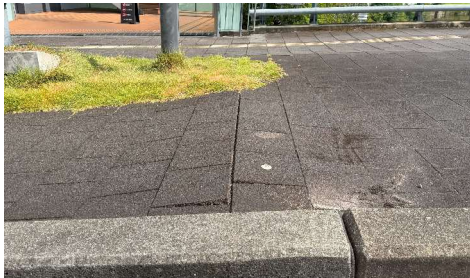
春日橋 (歩道ブロックのせり上がり等)
