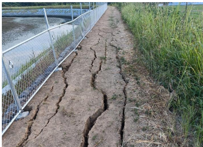
ため池の堤体のヒビ割れ（南区域南町/新地ため池）
