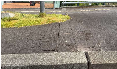
春日橋 (歩道ブロックのせり上がり等)
