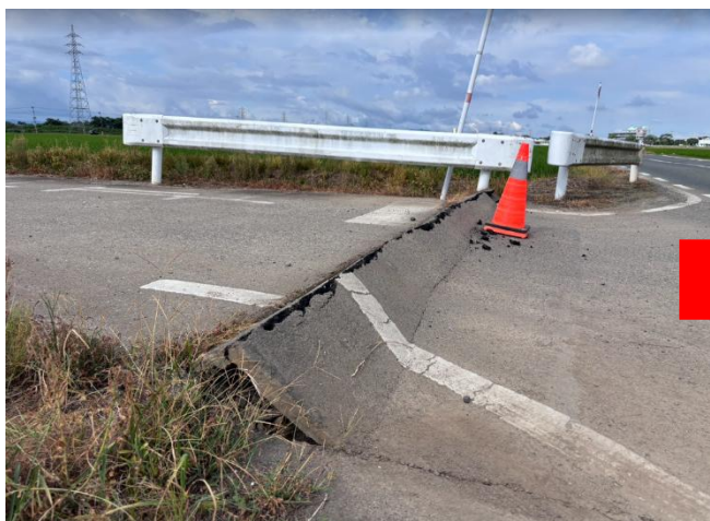
農道舗装板の破損（東区秋津）
