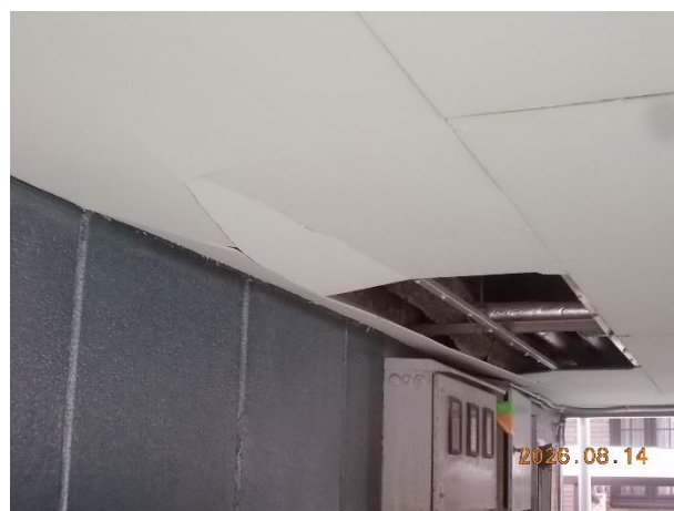
ポーチ天井被害
