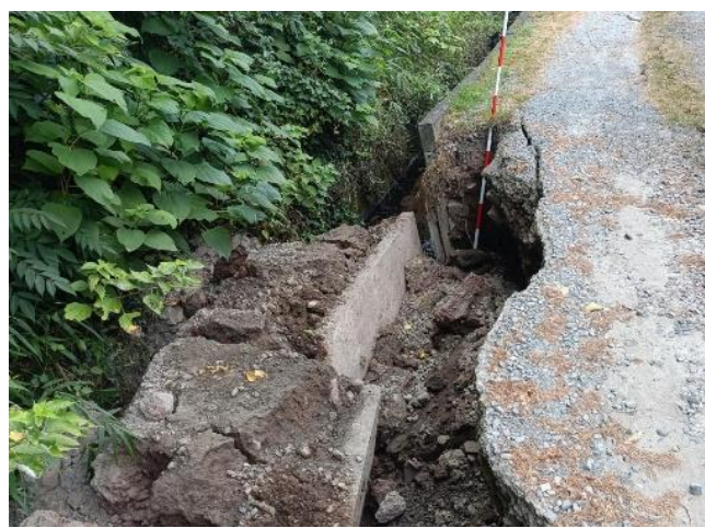
水路の崩落（南区城南町）
