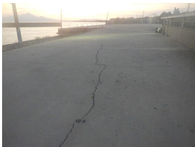
漁港の舗装のヒビ割れ（南区川口町）
