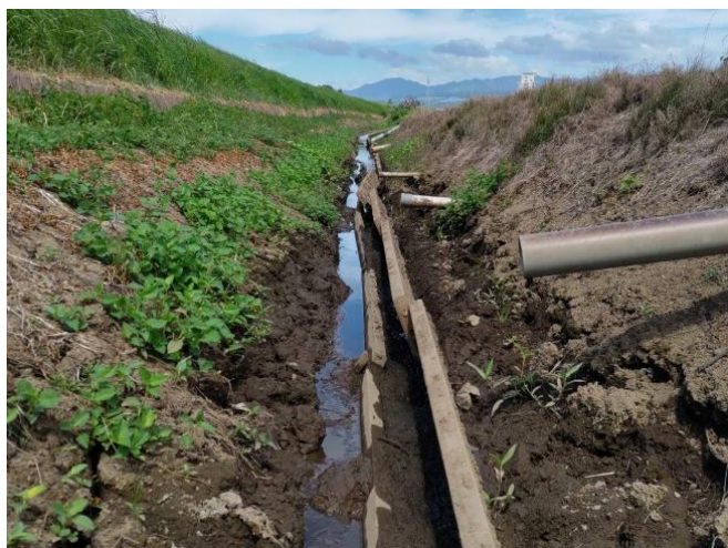
排水路の破損（東区秋津）
