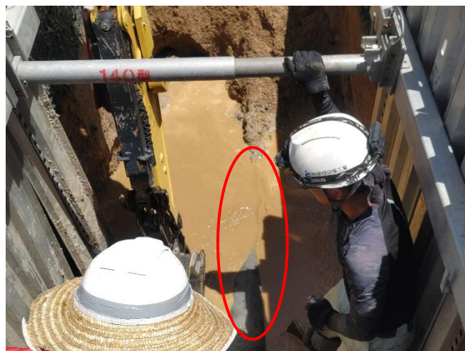
用水管の漏水（東区秋津）
