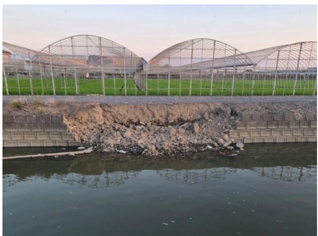
水路護岸の破損（南区富合町）
