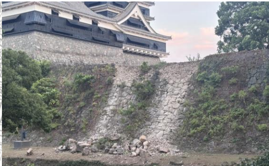
平左衛門丸石垣 崩落
