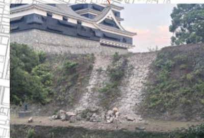
No.18平左衛門丸北側石垣 崩落
