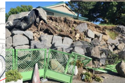
No.1加藤神社入口石垣 崩落
