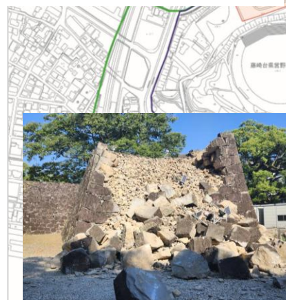
No.12連続枡形入口石垣 崩落
